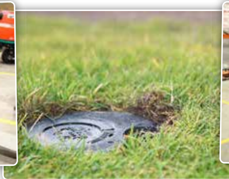
De Koksijde golfbaan heeft een modern eigen pompstation om het beregeningssysteem met circa 996 Rainbird pop-upsproeiers van water te voorzien.
